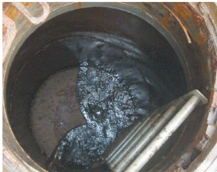
合流マンホール
